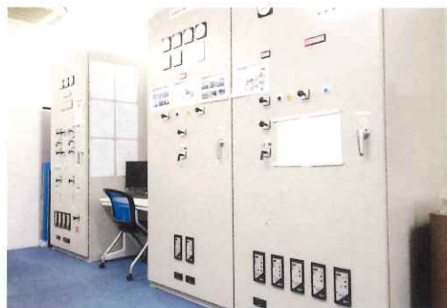
受変電設備の制御盤は全部で4面
