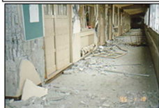
阪神・淡路大震災時の被害状況
