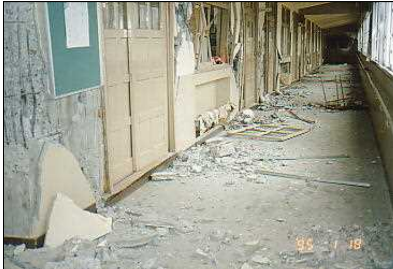
阪神・淡路大震災時の被害状況
