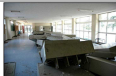
東日本大震災時の被害状況
