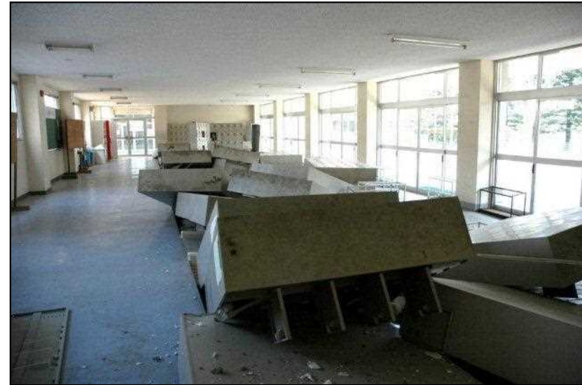
東日本大震災時の被害状況
