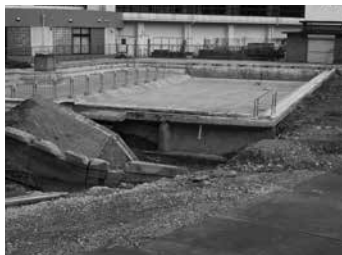
土砂の流出によりプールサイドが崩壊した丹波市立前山小学校のプール
