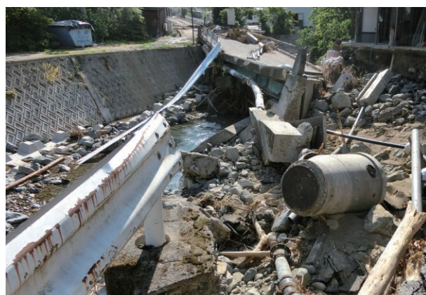
▲ 平成30年7月豪雨で崩落した橋
