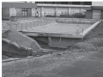
土砂に覆われ外壁が倒壊した丹波市立前山小学校のプール
