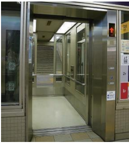
車いす使用者に 配慮したエレベーター
