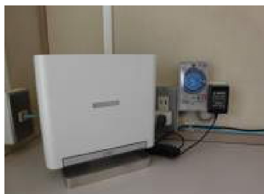
↑ 各教室に設置されたオゾン発生装置及びタイマー
