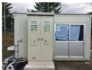
現場実験室および制御盤
