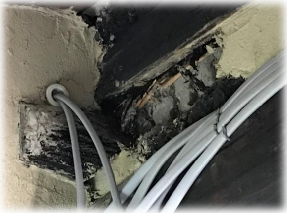
ケーブルを通す穴を開ける際失敗し、土壁を破壊。日本工科大学校の先生には許していただきましたが、丁寧な作業を行いましょう。
