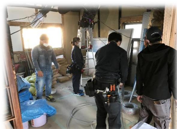
ケーブルの扱いも堀井電気様に見ていただき緊張しています。
