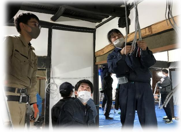
マジックで記入された結線先をしっかりと確認。
