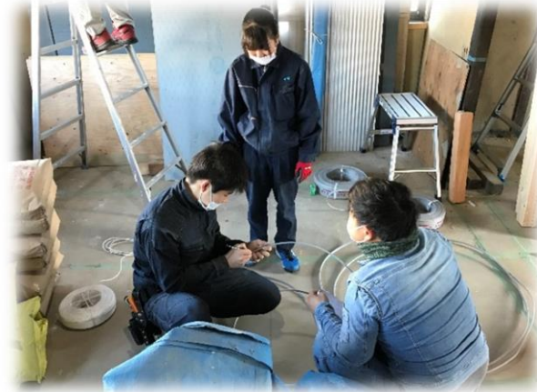
結線を間違えないように結線先をマジックで記入しています。
